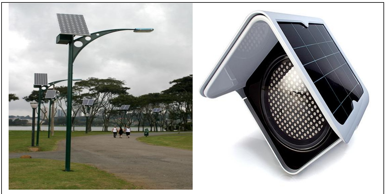
Figura 13: Sistema de iluminação pública e de sinalização que utilizam a energia solar.
