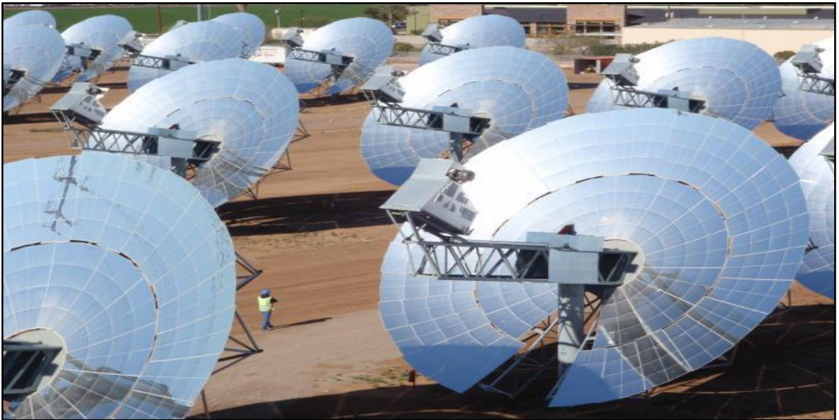
Figura 6: Usina comercial solar que utiliza coletores de concentração.
